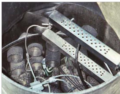
V případě potřeby (zavedení kabelů) můžou být stupadla odstraněny.
