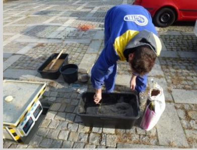
pro výplň víka řádně rozmícháme mrazuvzdornou lepicí směs (jedno balení 25 kg stačí na dvě velká víka)
